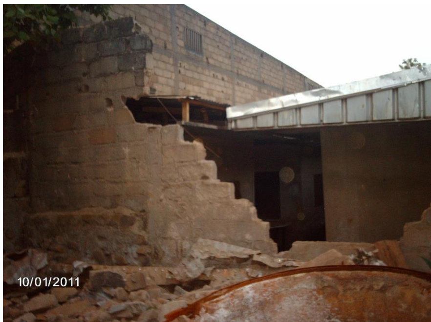
Photo 2: Maison détruite après l'explosion d'une chaudière de SCS en octobre 2010
