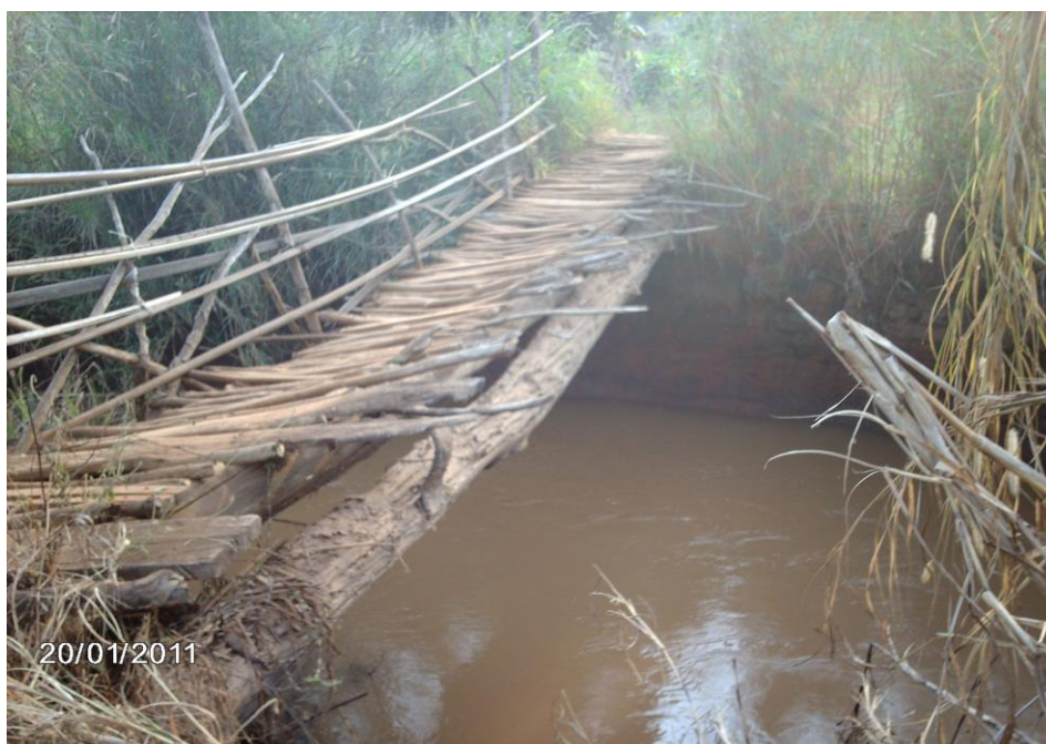
Photo 4 : Etat du pont Reliant King place à Djukou
